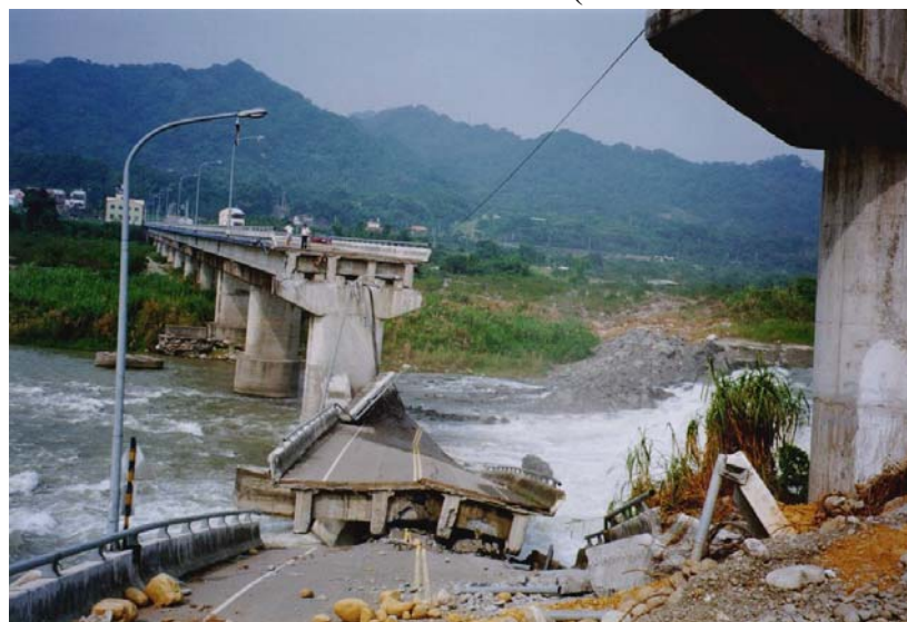
圖 6.1-3 埤豐橋由於斷層通過造成之落橋破壞
