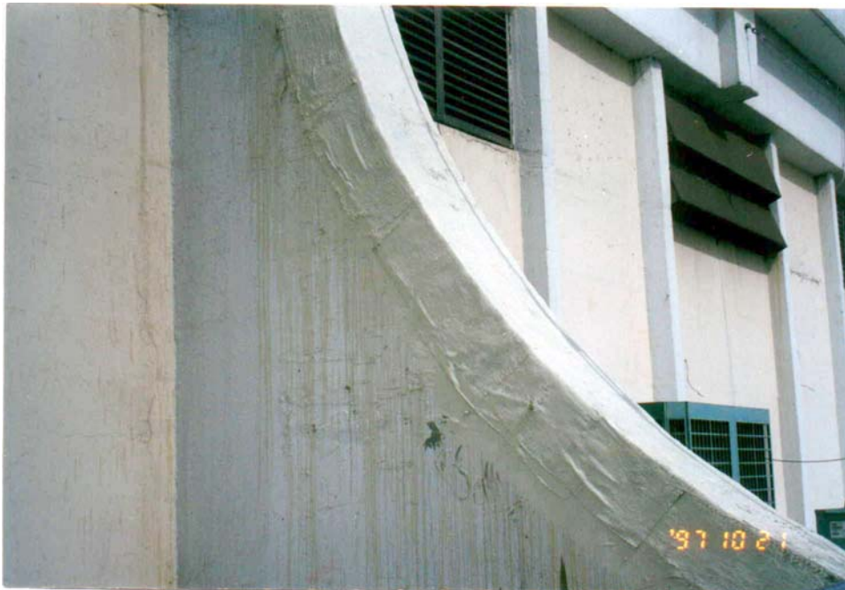
圖 10.6-12 皺紋之劣化狀況 [52]
