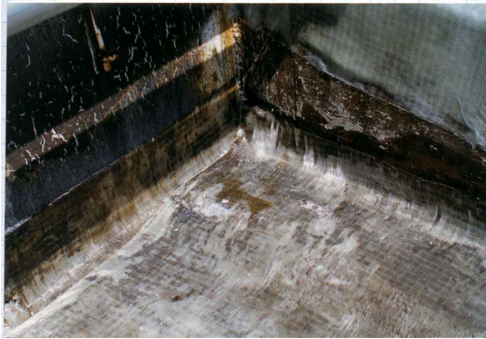
圖 10.6-11 缺脂之劣化狀況 [52]
