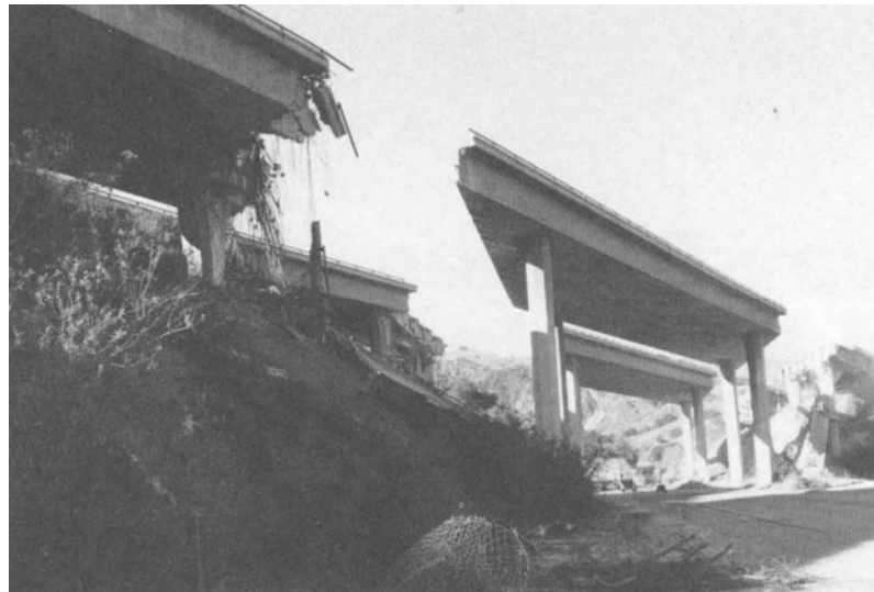
圖 6.1-2 美國I-5,Gavin Canyon Undercrossing之落橋破壞 (資料來源：F.Seible攝)
