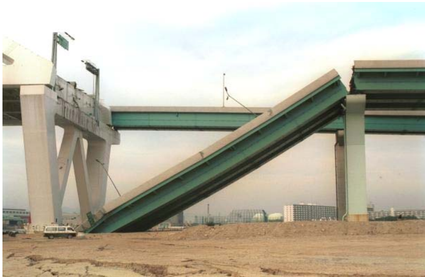
圖 6.1-12 日本西宮大橋因阪神地震造成土壤液化及落橋破壞 (資料來源：M. Yoshimiue攝)
