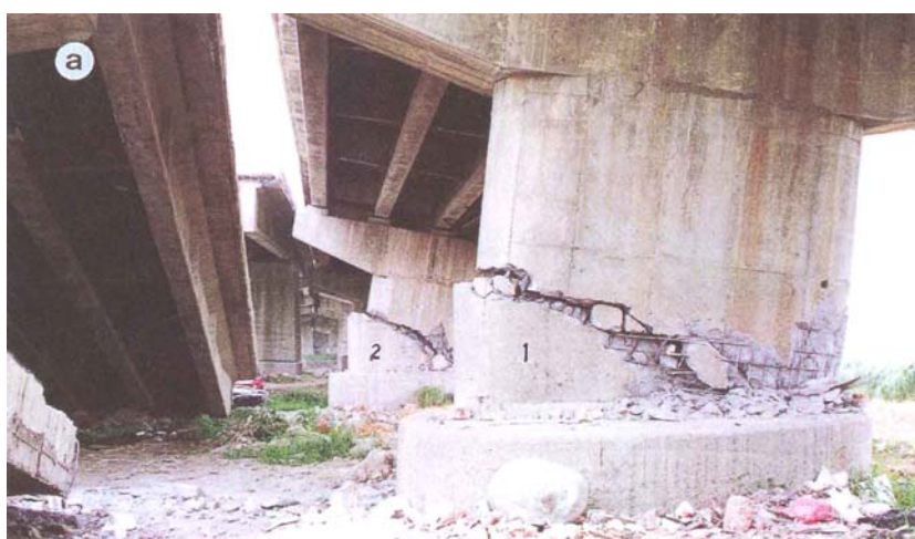
圖 6.1-7 RC橋柱之剪力破壞(二) [16]
