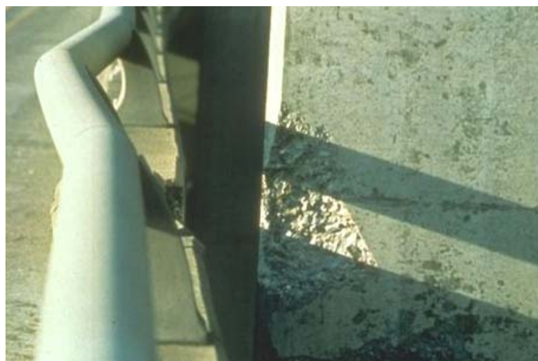
圖 6.1-5 美國I-280州際公路因地震變位碰撞到橋柱
