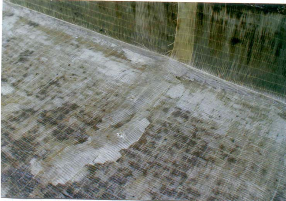
圖 10.6-13 空孔、氣泡之劣化狀況 [52]
