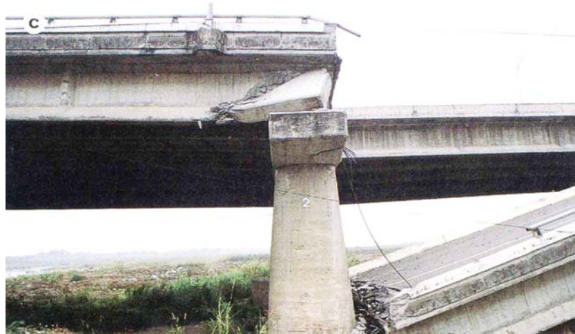
圖 6.1-1 支承長度不足之落橋破壞 [16]
